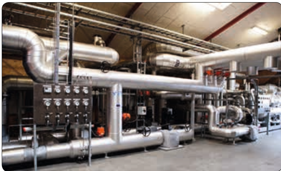
Varmepumpen i Brædstrup. Foto: Nils Rosenvold
