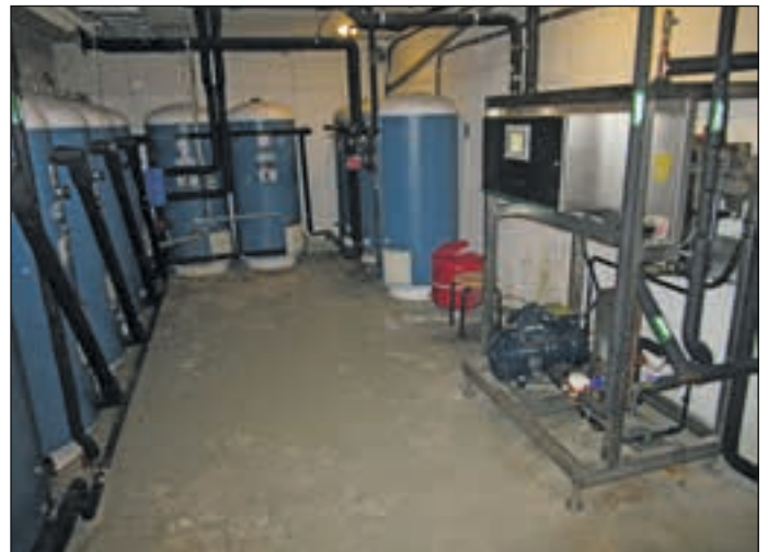
Teknisk rom CO 2 -varmepumpe Romolslia.
