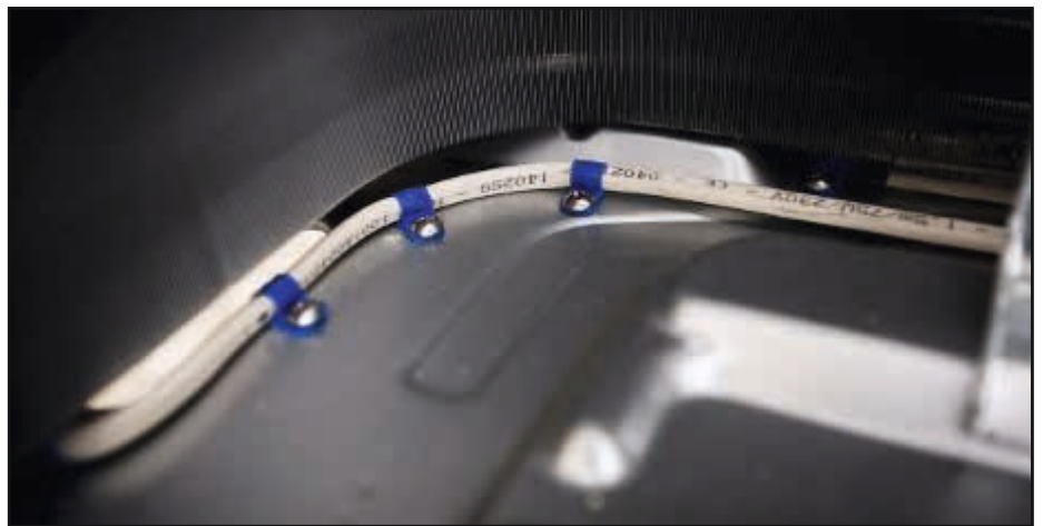
Varmekabel i utedelen forhindrer is og demper støyen.
