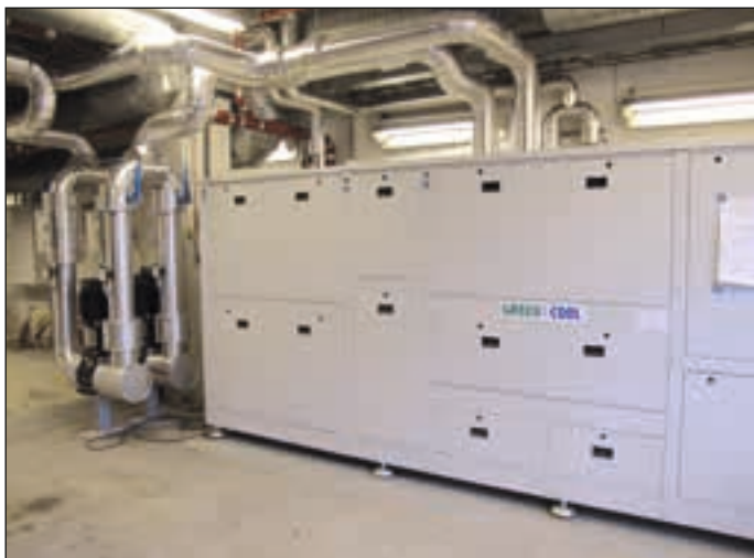
CO 2 -varmepumpe ved Universitetssykehuset i Tromsø.
